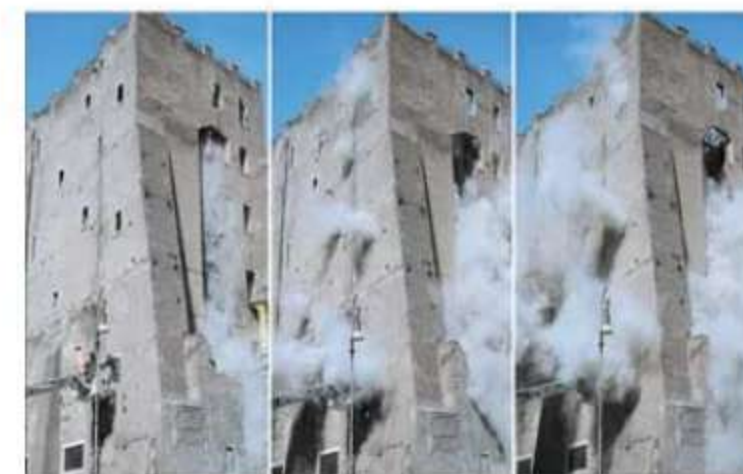
Colapso. Durante tareas de renovación.
